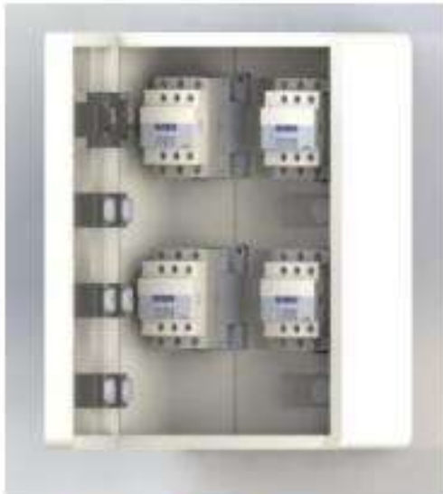
Figura 3.6 Vista interior del tablero de control
