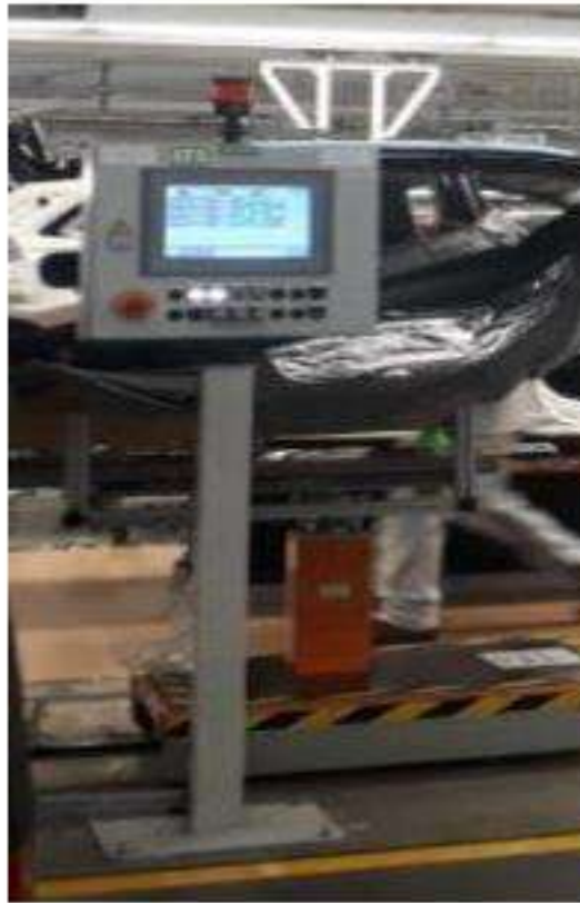
Figura 40.- Instalación de la pantalla táctil HMI.
