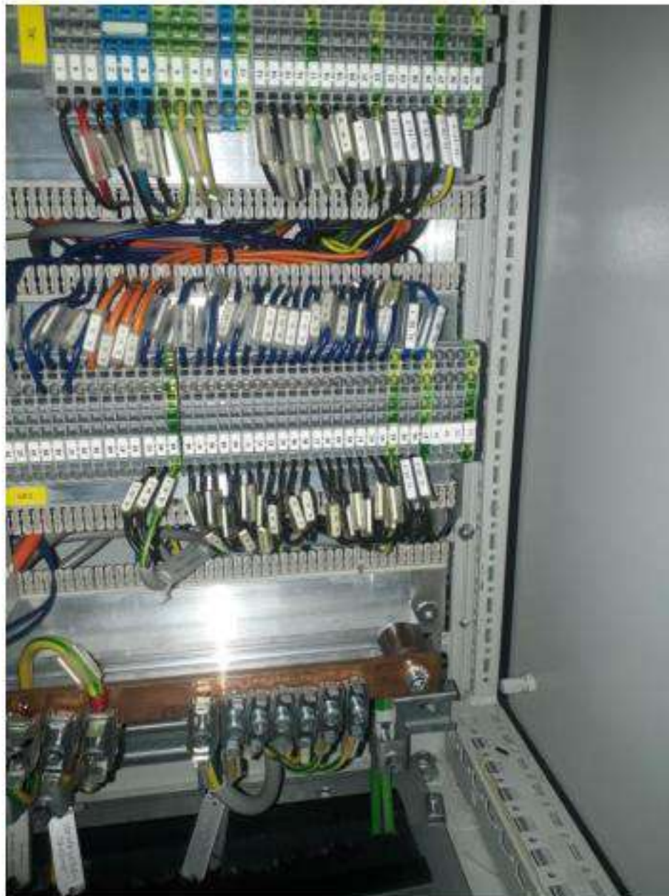
Figura 38.- Integración y conexión de tablero eléctrico.
