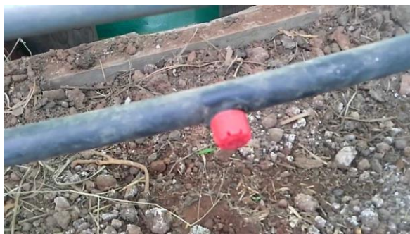
Figura 5.20 Goteros en cada línea de riego
