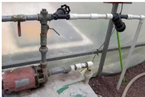
Figura 5.17 Bomba eléctrica del sistema de riego
