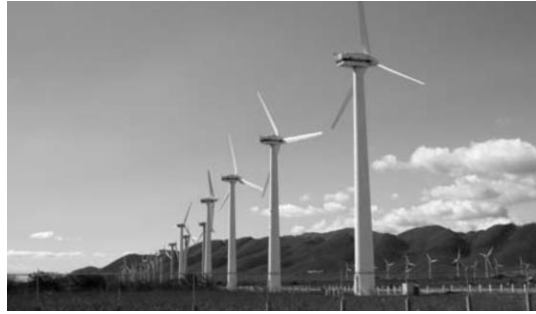
Figura 20. Central eoloeléctrica de La Venta II. Fuente: [16]
