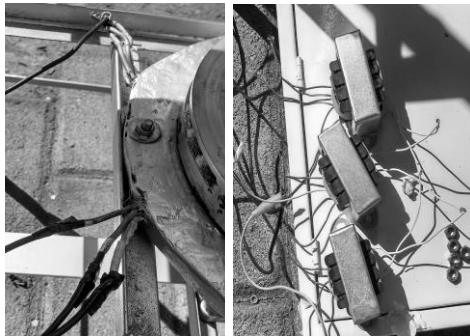
Figura 76. Conexión física del estator hacia los transformadores. Fuente: Propia.
