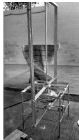
Figura 66. Aplicación de base de pintura en la base de acero. Fuente: Propia.
