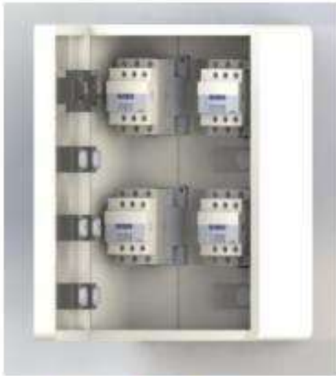
Figura 3.6 Vista interior del tablero de control
