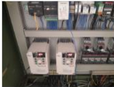
Figura 2.57: Tablero seccion de VDF, guardamotores y contactores de paso.
