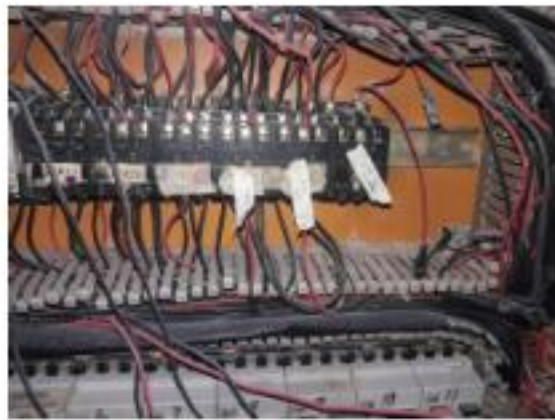
Figura 1.2: Estado de componentes electricos en Maquinaria Zell.
