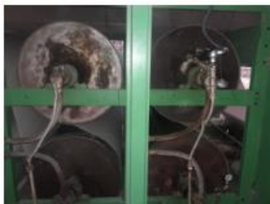
Figura 2.26: Instalación del Pt100.
