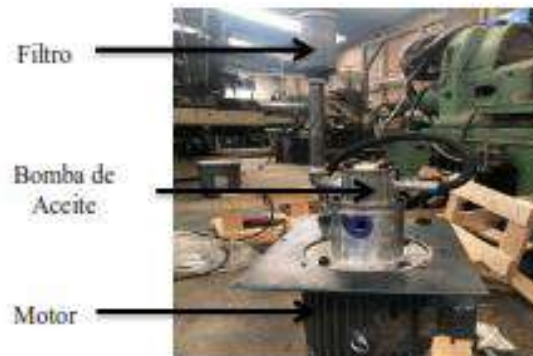
Figura 6. Unidad de Potencia.
