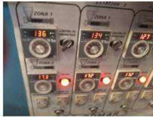
Figura 7. Tablero de Control.
