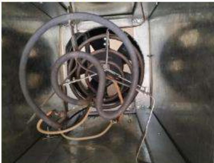
Figura 16 Sistema de Calefacción y ventilador
