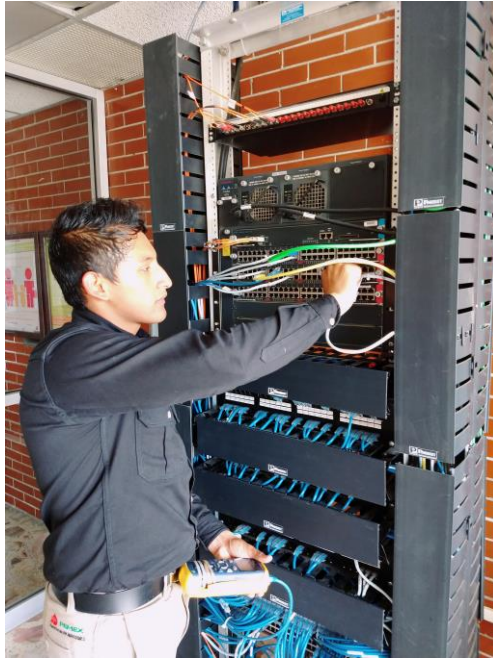
Figura 23. Conexión de Switch a Router
