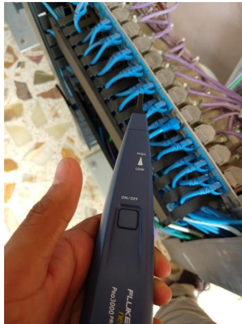
Figura 32. Localización de Cable UTP
