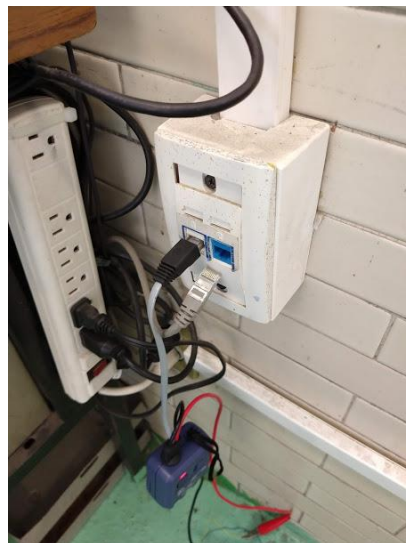
Figura 31. Ubicación de Cable UTP
