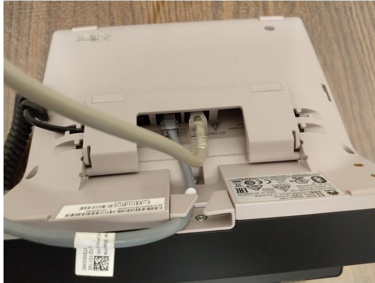
Figura 27. Conexión de Cables UTP a Teléfono VoIP
